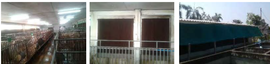
ภาพ ภายในโรงเรือนEVAP การใช้สแลนบังแดดอาคาร และติดตั้งสปริงเกอร์บนหลังคาโรงเรือน
